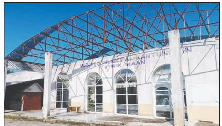
Fragmentos de concreto caen, por lo que peatones peligran. (POR ESTO!)
