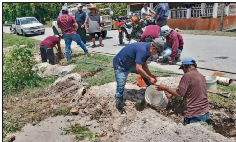
El agua se escapaba por la tubería de cuatro pulgadas. (POR ESTO!)
