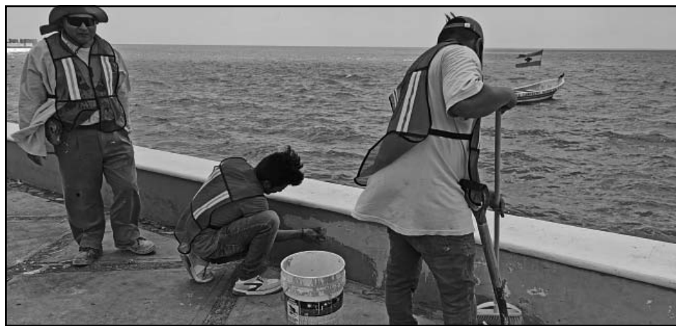
Los trabajos actuales son mejoras superficiales, pero no incluyen atención a hundimientos.
