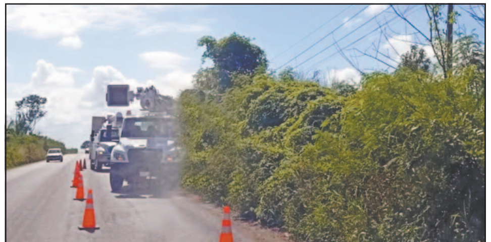
Las últimas lluvias y los vientos provocaron daños en los cables. (Fotos Efrén Martín)
