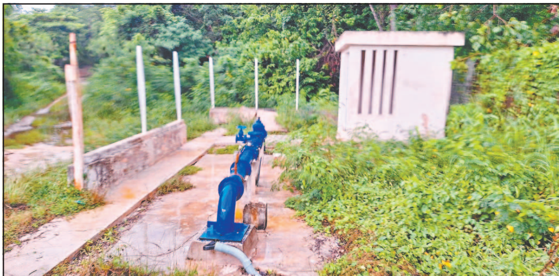
Para evitar daños, los equipos estarán fuera de operación hasta que se normalice el servicio. (Justino Xiu)
