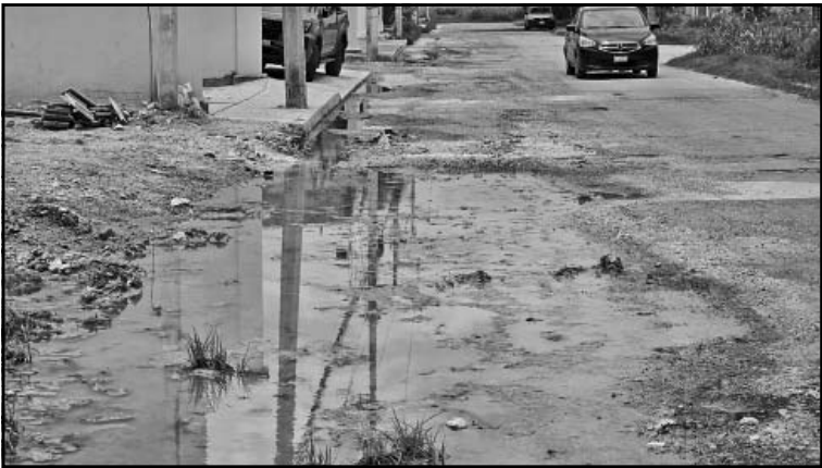
Vecinos señalan fallas en drenaje, baches y falta de mantenimiento.
