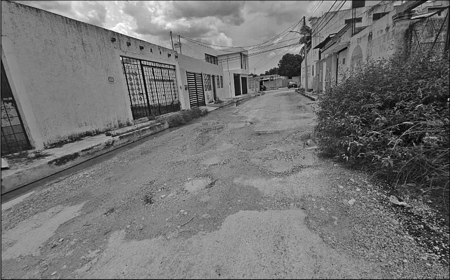
Los enormes hundimientos complican el tránsito cotidiano por las calles de la colonia. El daño también alcanza escarpas y terrenos baldíos.
