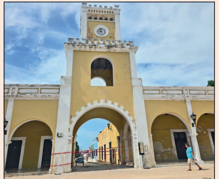
Con más de 80 años, la estructura cedió por falta de mantenimiento.
