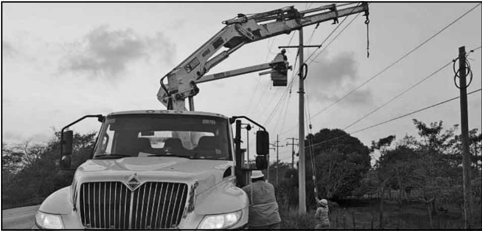
El proyecto busca atender las necesidades de infraestructura eléctrica de la zona.
