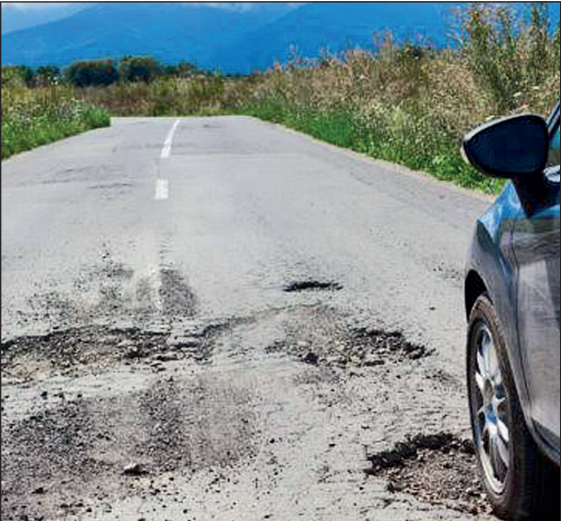
Cerca de 65 por ciento de los caminos requiere algún grado de atención para mejorar su funcionamiento.
