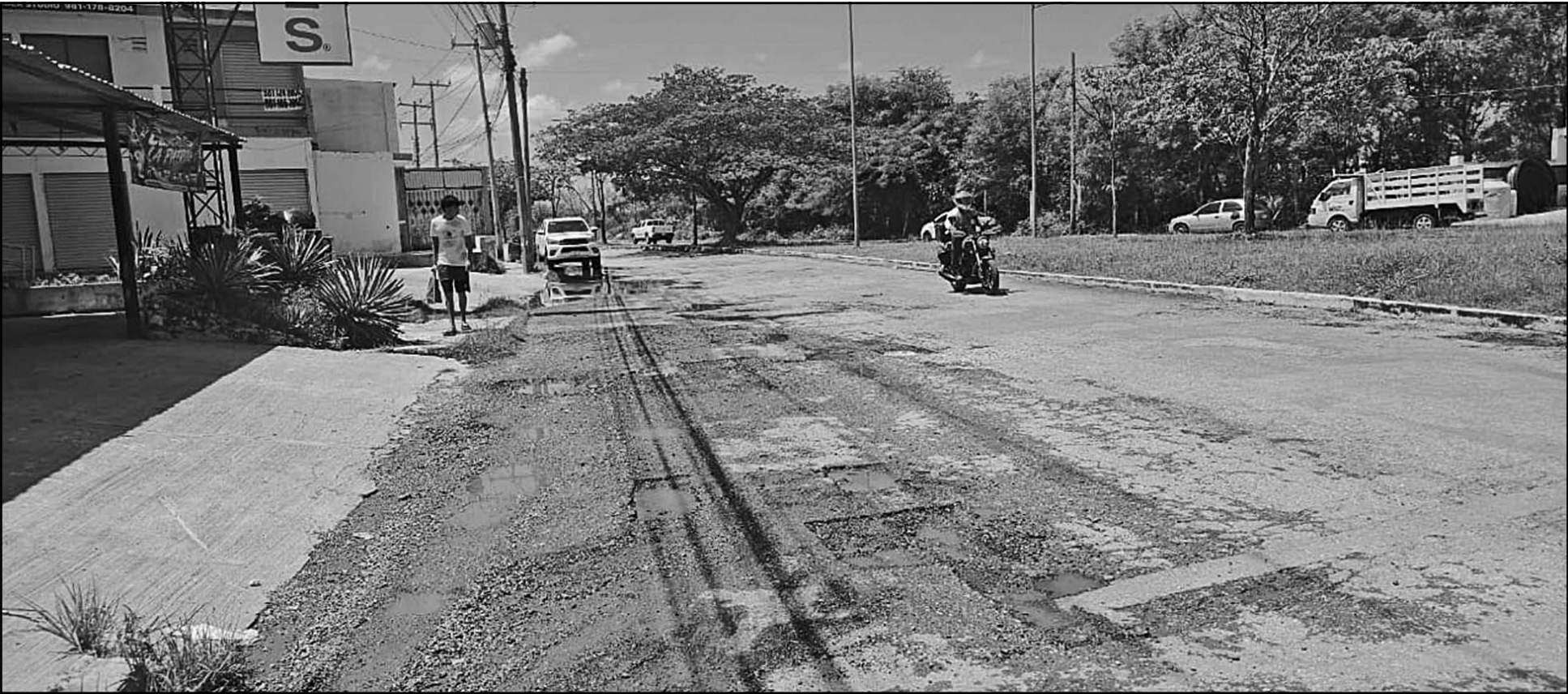
Habitantes aseguran que el sector lleva más de dos décadas sin una rehabilitación. La maleza invade aceras fracturadas y obliga a transeúntes a caminar sobre la carpeta vehicular.
