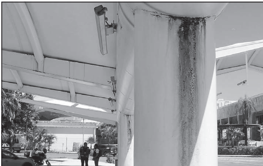
Las estructuras fueron instaladas hace 19 años y requieren una nueva capa de pintura.
