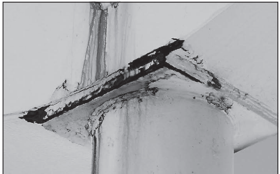
Trabajadores solicitaron atender el área, pues hay partes a punto de desprenderse.
