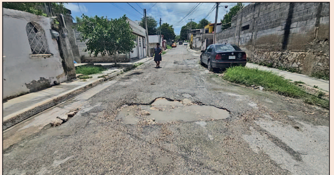
Baches, banquetas destruidas, tuberías expuestas y falta de alumbrado afectan a la Ignacio Zaragoza.
