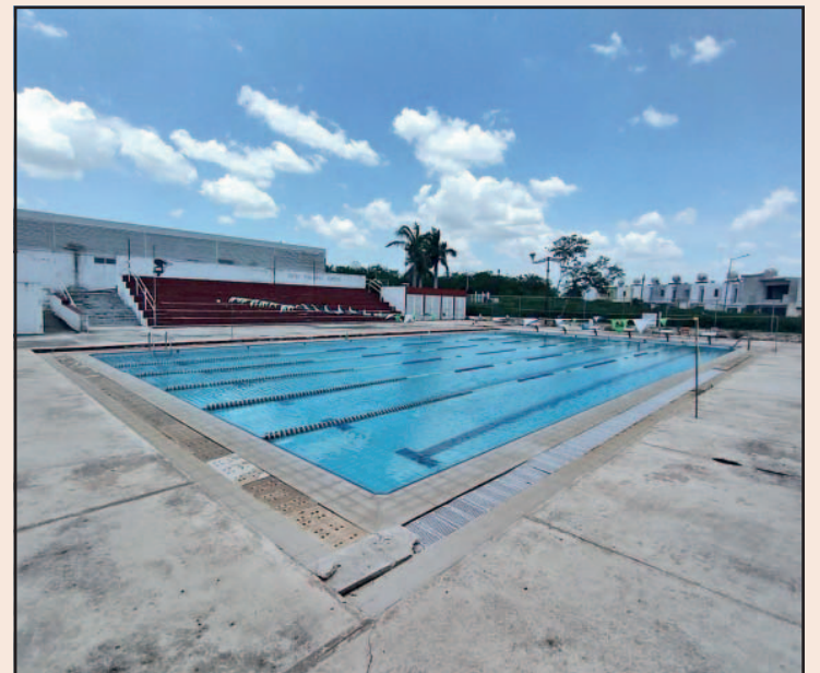
Indecam admite deterioro de la “20 de Noviembre”. (A. Balan)
