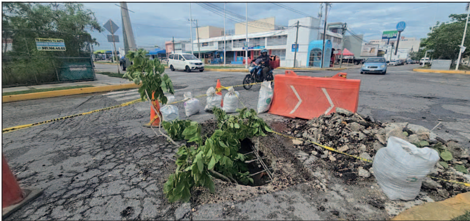
El deterioro se atribuye al impacto de la humedad, la corrosión y las lluvias recurrentes. El problema involucra al Ayuntamiento y a CFE.
