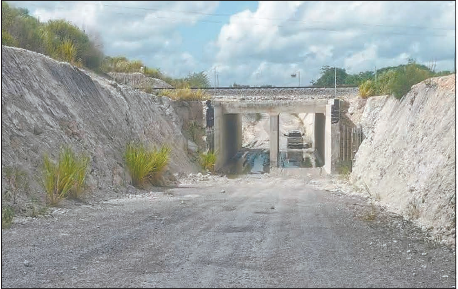
Los pobladores mencionaron que el canal es angosto y presenta fallas, lo que causa la acumulación de más de un metro de líquido pluvial. (POR ESTO!)
