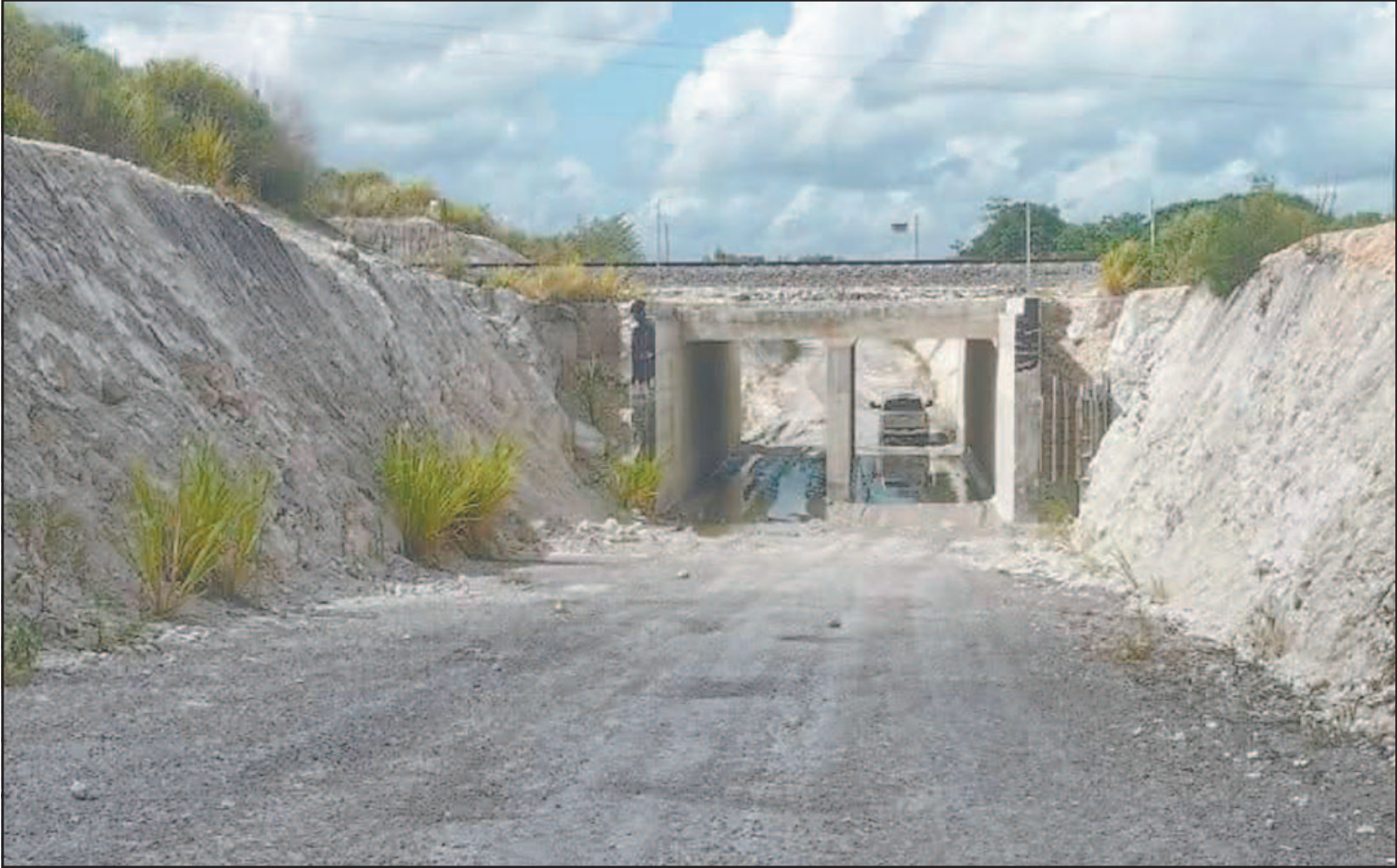
Los pobladores mencionaron que el canal es angosto y presenta fallas, lo que causa la acumulación de más de un metro de líquido pluvial. (POR ESTO!)
