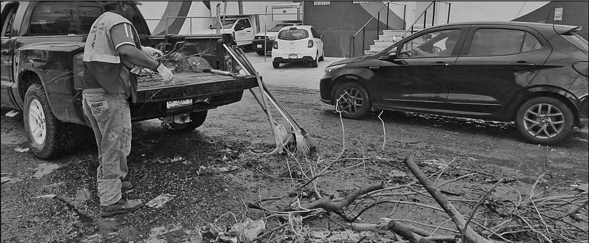
El funcionario de Protección Civil señaló que la obstrucción del drenaje por residuos provocó severos encharcamientos en distintos puntos del Estado. (Alejandro Balan)
