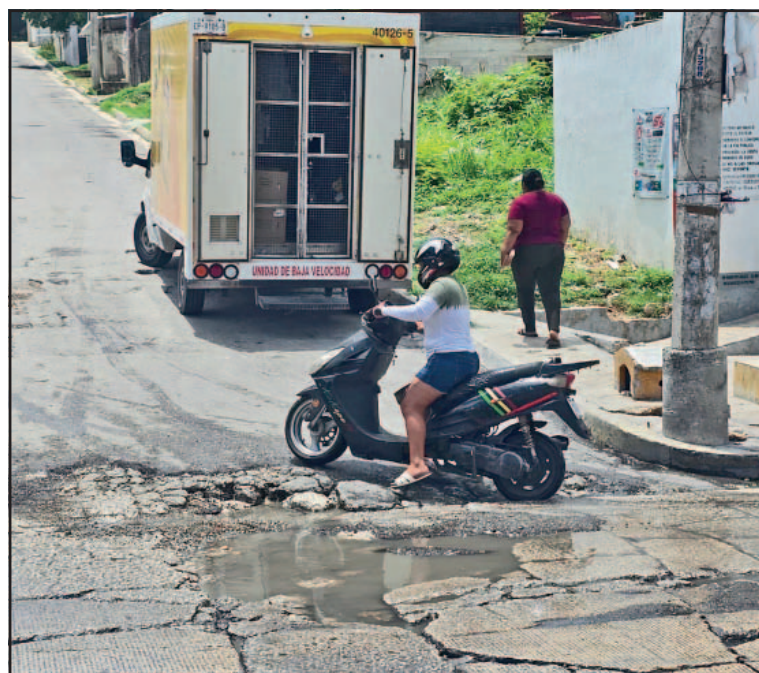
Los hundimientos llevan años sin ser reparados. (Alejandro Pech)
