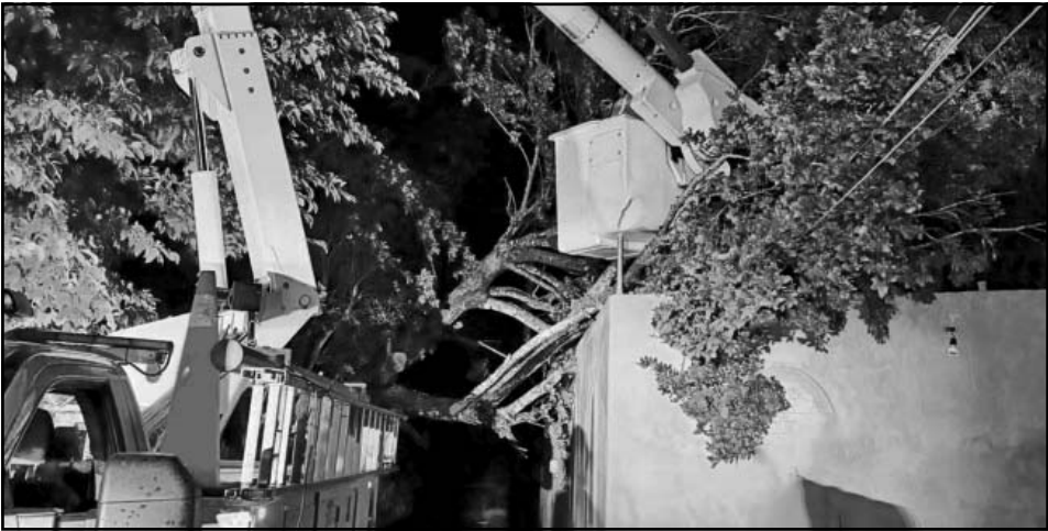
La CFE trabajó para restablecer el suministro eléctrico en las zonas afectadas. (Especial)
