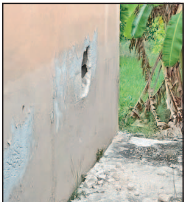
Sendo hueco le hizo a la pared.
