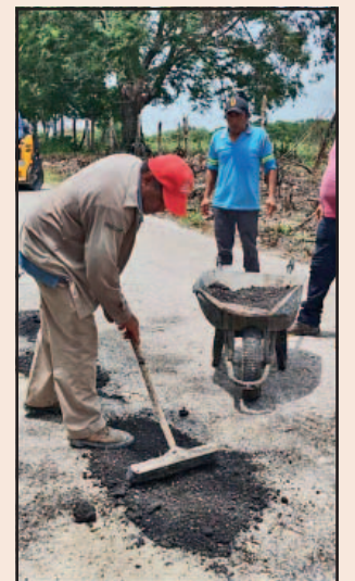
La vía se encontraba en lamentables condiciones.
