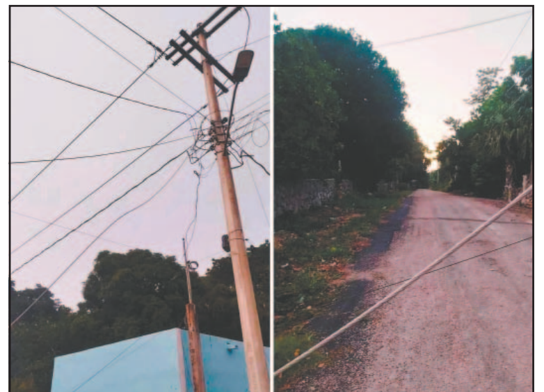
Un cable de alta tensión permanece sobre la carretera. (POR ESTO!)
