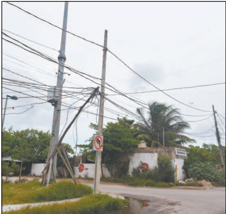
Solicitaron una revisión preventiva de los transformadores. (E. Silva)
