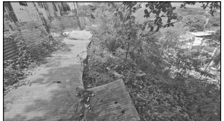
Las placas de concreto ya cedieron ante el deterioro. (Alejandro Pech)
