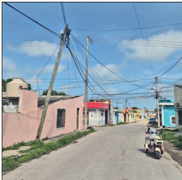
El problema se ubica sobre la calle 27, entre 26 y 24. (Jorge May S.)
