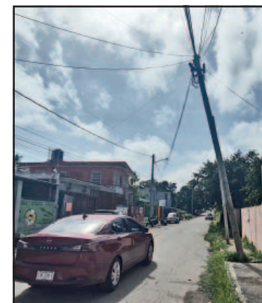
La estructura ha sido reportada.
