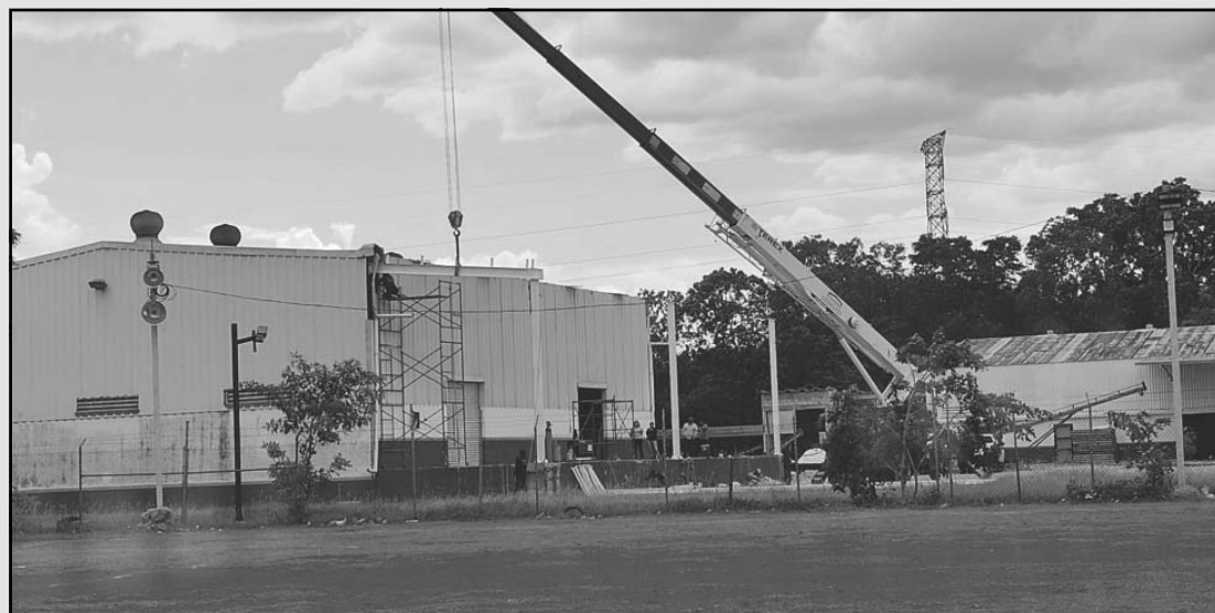
Con estas acciones se evitarán posibles accidentes, ya que se trata de un sitio muy concurrido.
