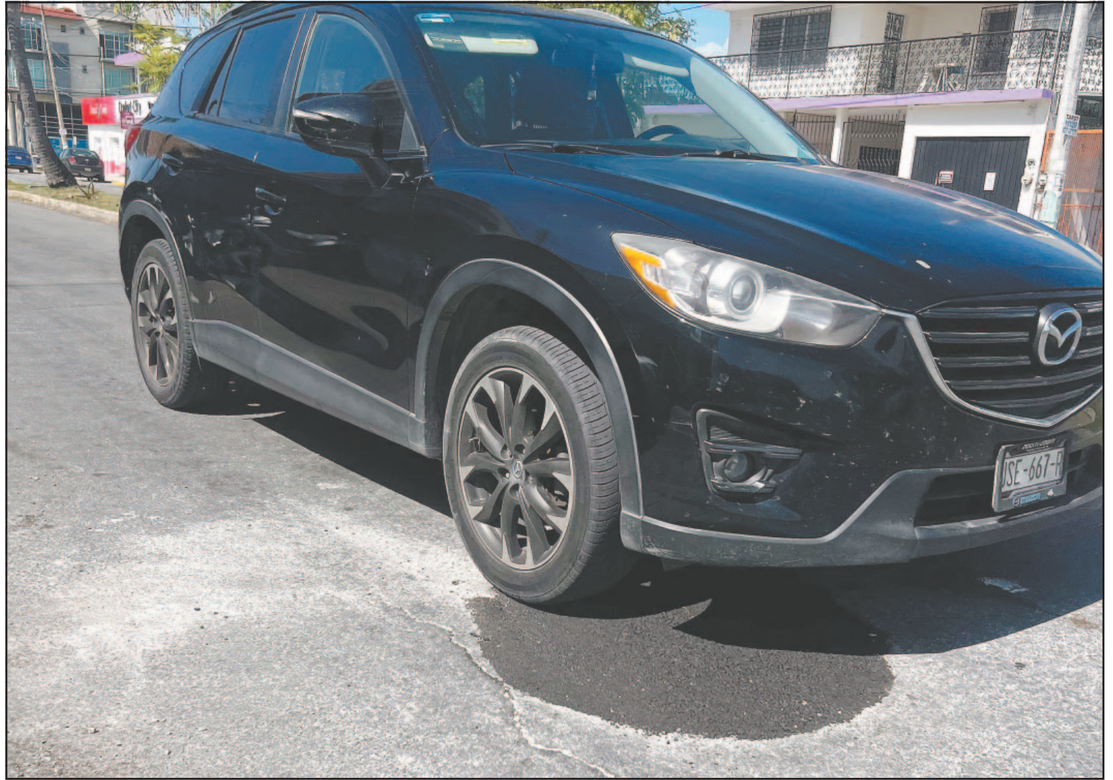
Pobladores dudan de la durabilidad de los trabajos realizados el viernes pasado en la avenida Benito Juárez; temen que ocurra algún accidente.
