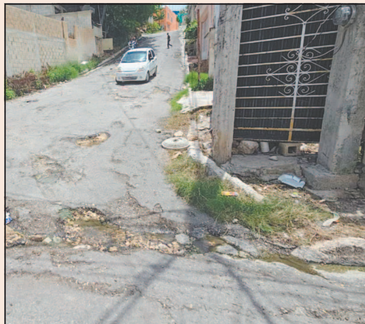
La propietaria tuvo que costear las afectaciones estructurales.
