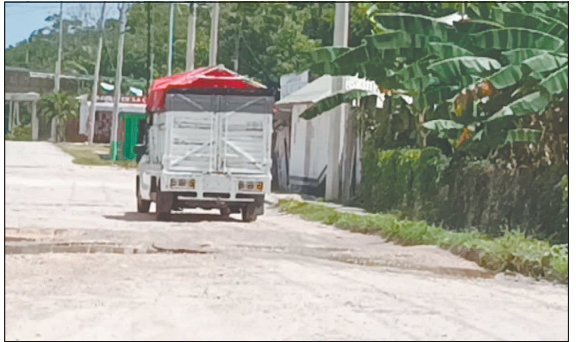
Los usuarios se quejan por las afectaciones a sus unidades y las costosas reparaciones. (POR ESTO!)
