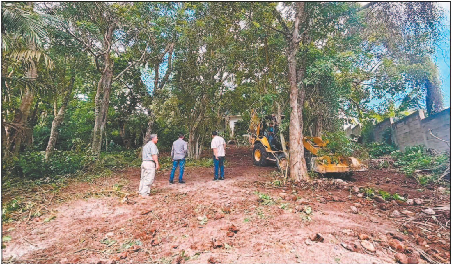
Algunos de los terrenos estaban a punto de convertirse en basureros clandestinos y otros eran usados como guarida de delincuentes.
