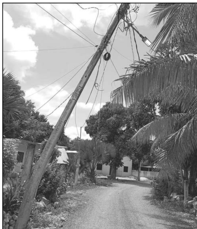
La columna presenta una fractura casi a la mitad y permanece inclinada.
