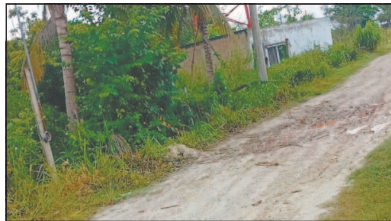
Vecinos alertan por lodo y baches que dificultan el tránsito. (Especial)
