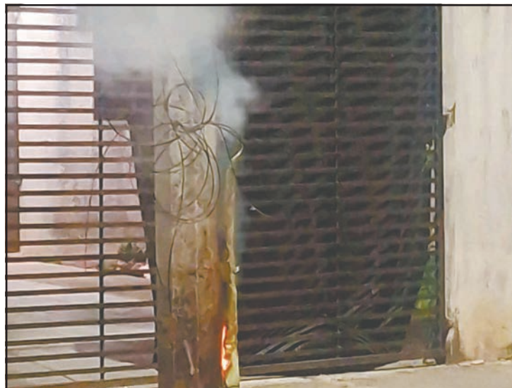
Las llamas no llegaron a otros componentes de la infraestructura. (F. Baeza)
