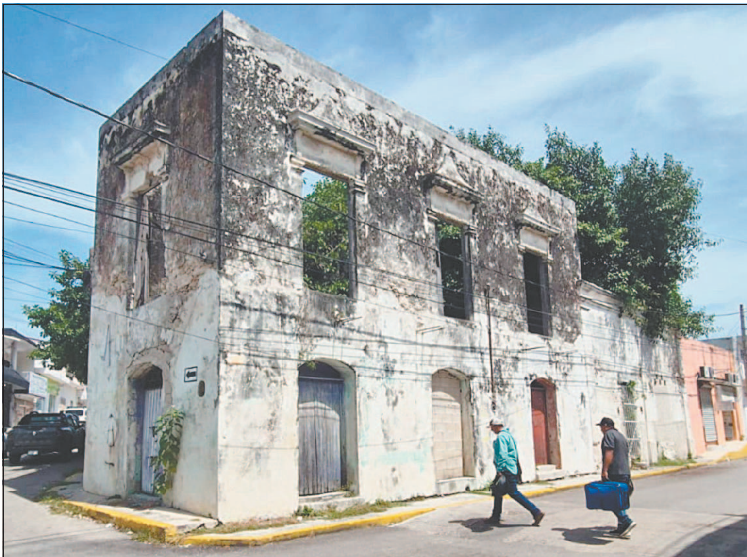
Algunos de los añejos inmuebles representan un riesgo para los peatones y conductores porque están al borde del colapso. (Jorge May)
