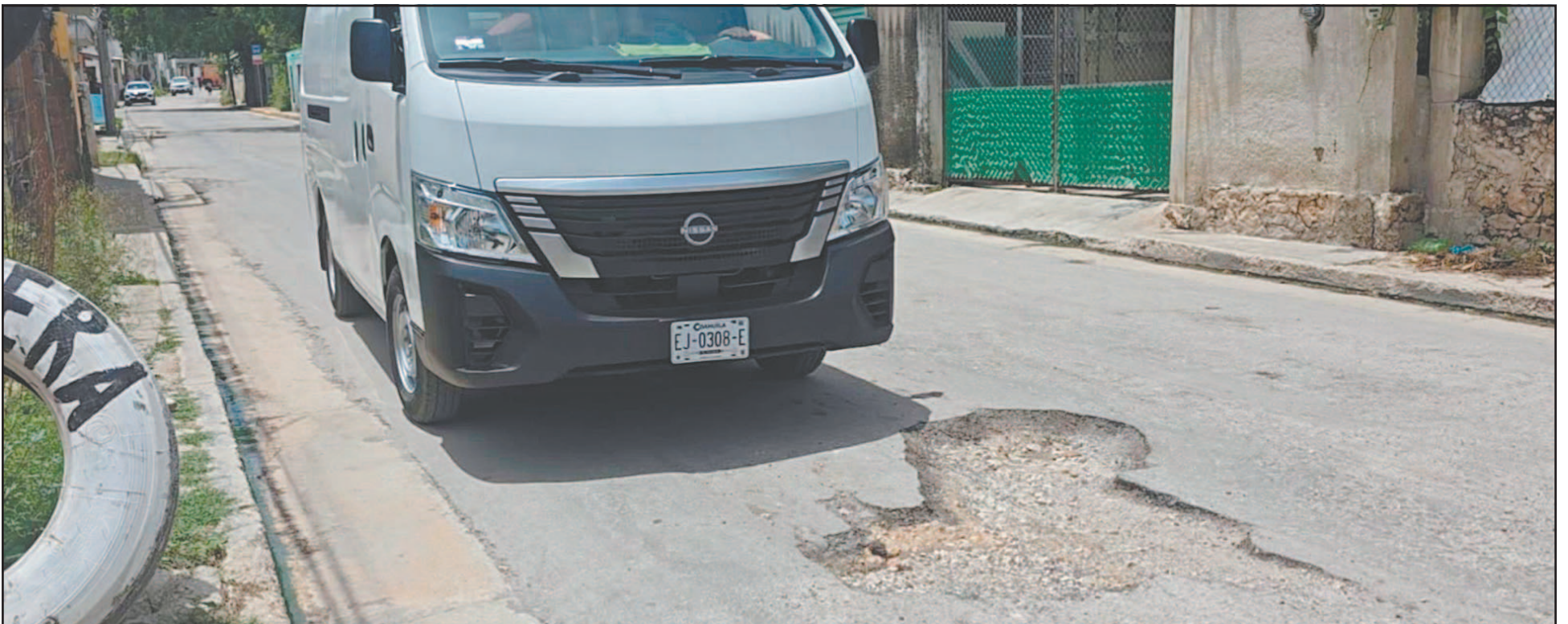
Las reparaciones realizadas por el Ayuntamiento de Campeche presuntamente no resisten las lluvias, por lo que los bacheos vuelven a deteriorarse rápidamente. (A. Pech)
