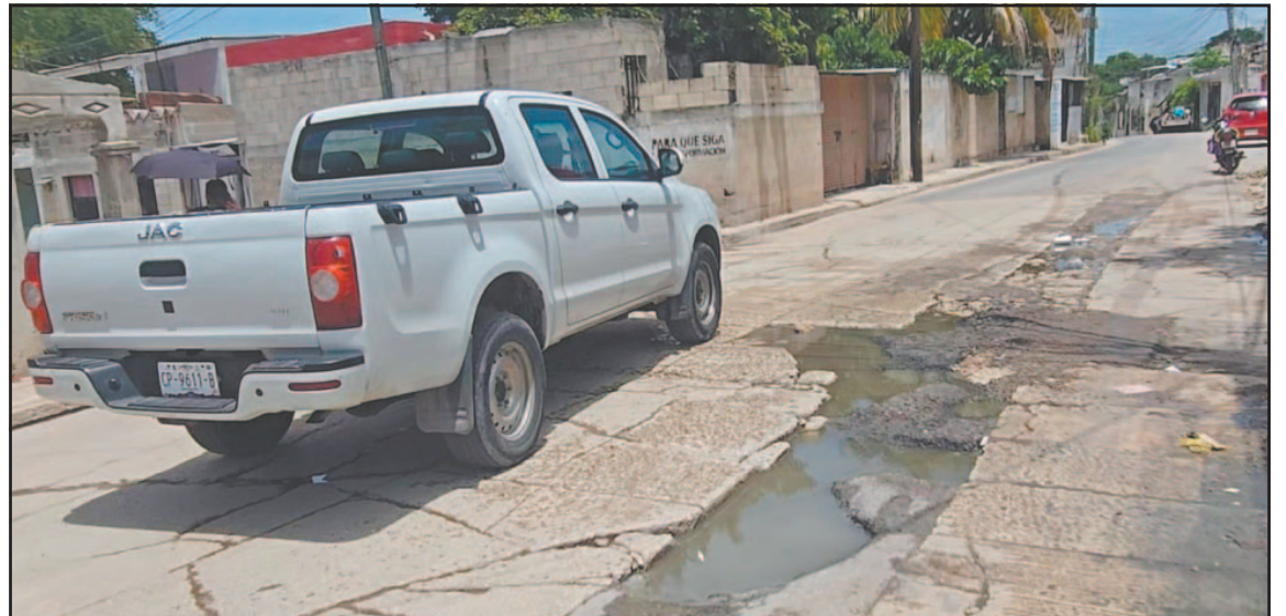
Zanjas abiertas desde la sustitución de la infraestructura de agua potable permanecen sin ser reparados.
