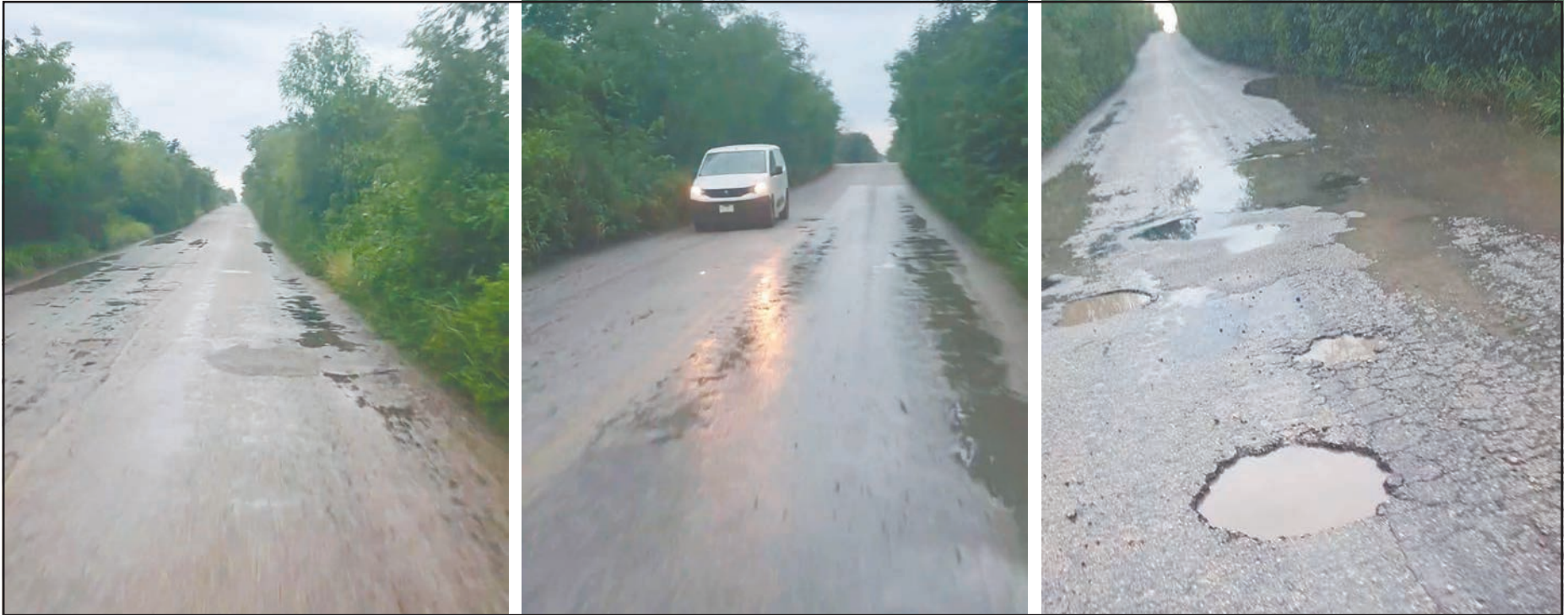
Subdelegados señalaron que las lluvias agravaron los huecos y que la maleza invadió la vía, propusieron colaborar con el Ayuntamiento a cambio de apoyo económico. (E. Cauch)
