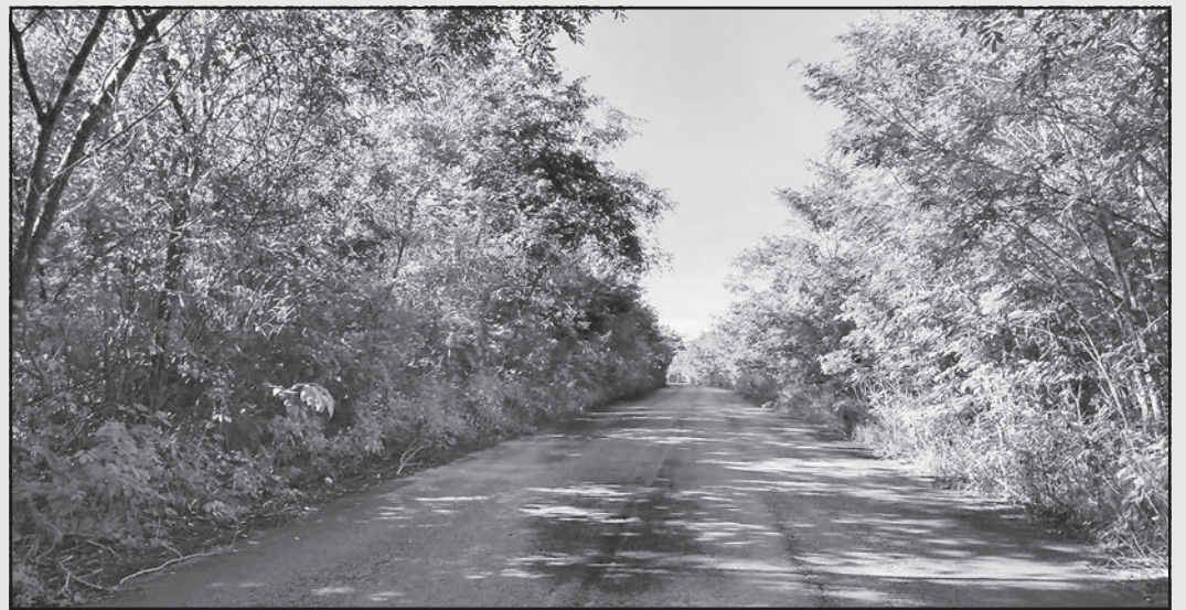
Son 14 kilómetros de carretera que actualmente se encuentran en deplorable estado. (Justino Xiu)
