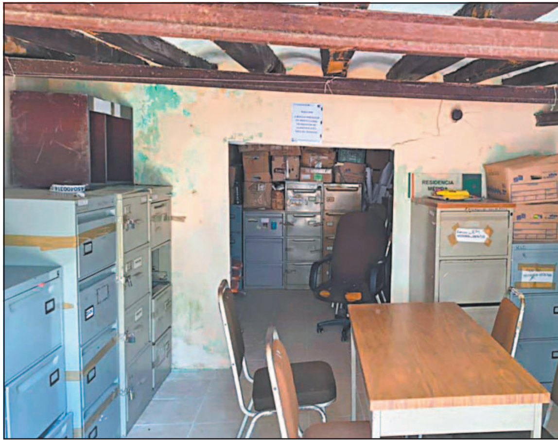
El inmueble no tiene ventanas, aire acondicionado ni condiciones sanitarias adecuadas. (POR ESTO!)
