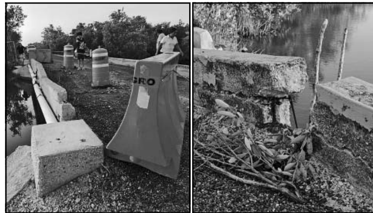
La zona permanece acordonada para evitar accidentes. (E. Caamal)
