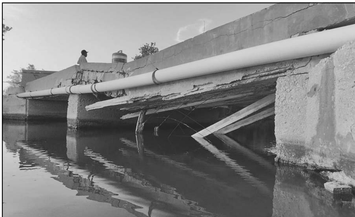
El paso de camiones con carga diversa destapó el presunto uso de materiales de mala calidad. (Erik C.)
