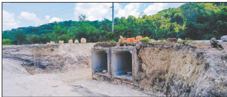
Las intensas lluvias convirtieron el camino rural en una peligrosa trampa. (POR ESTO!)
