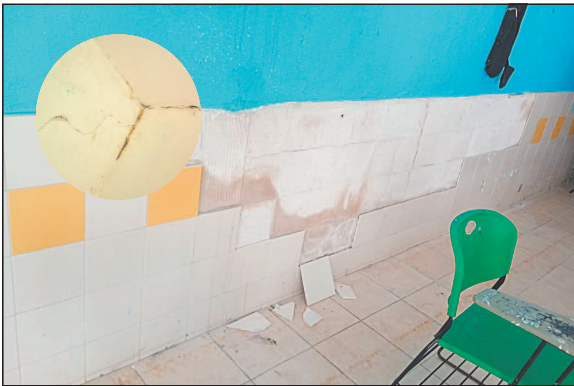
Mentores señalaron una serie de deficiencias en la primaria ubicada en Muchucuxcah, Valladolid.
