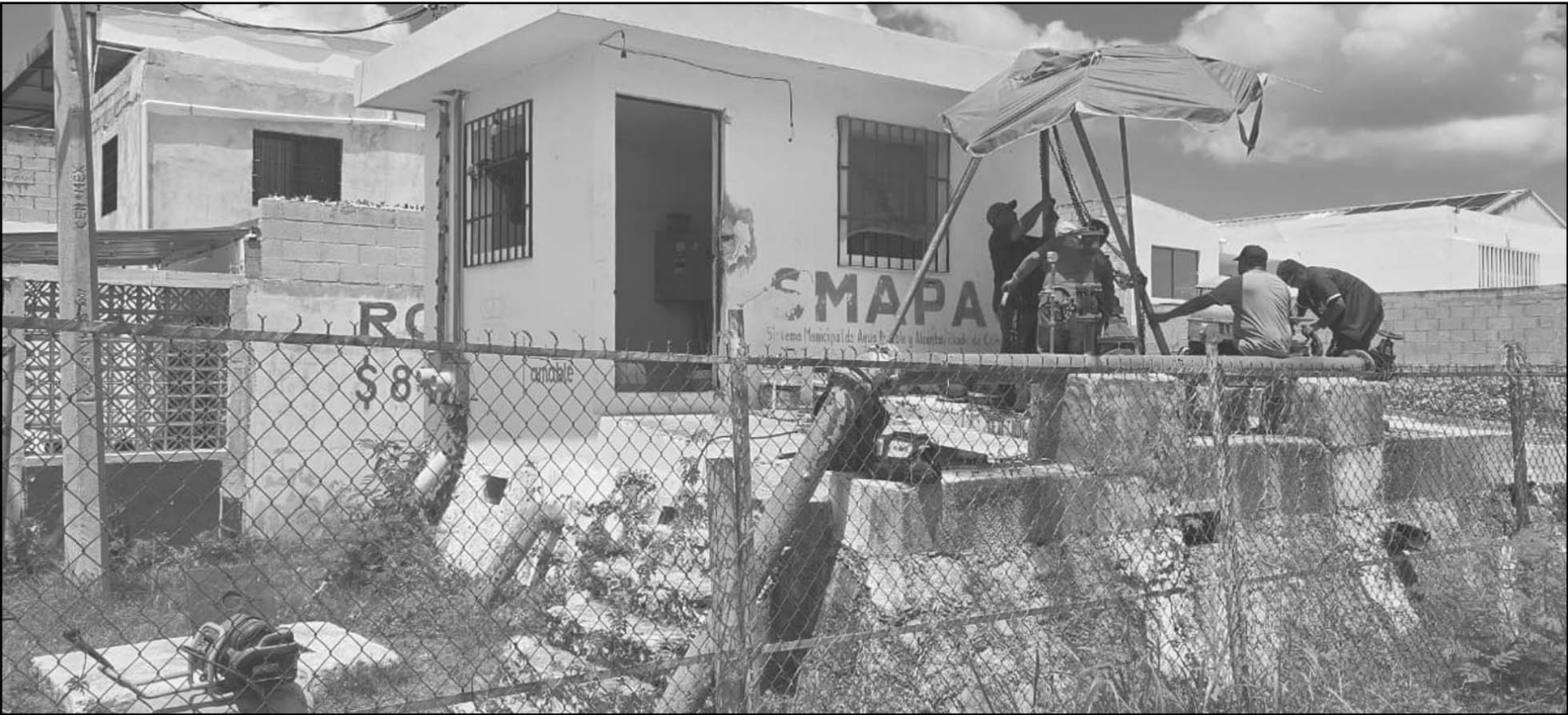
Las tuberías presentan obstrucciones por acumulación de sarro, lo que afecta el suministro. La escasez ha obligado a algunos a acudir a casas de allegados para bañarse y lavar ropa.
