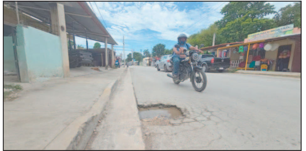
Las lluvias agravaron los baches y daños en las principales vialidades del poblado.
