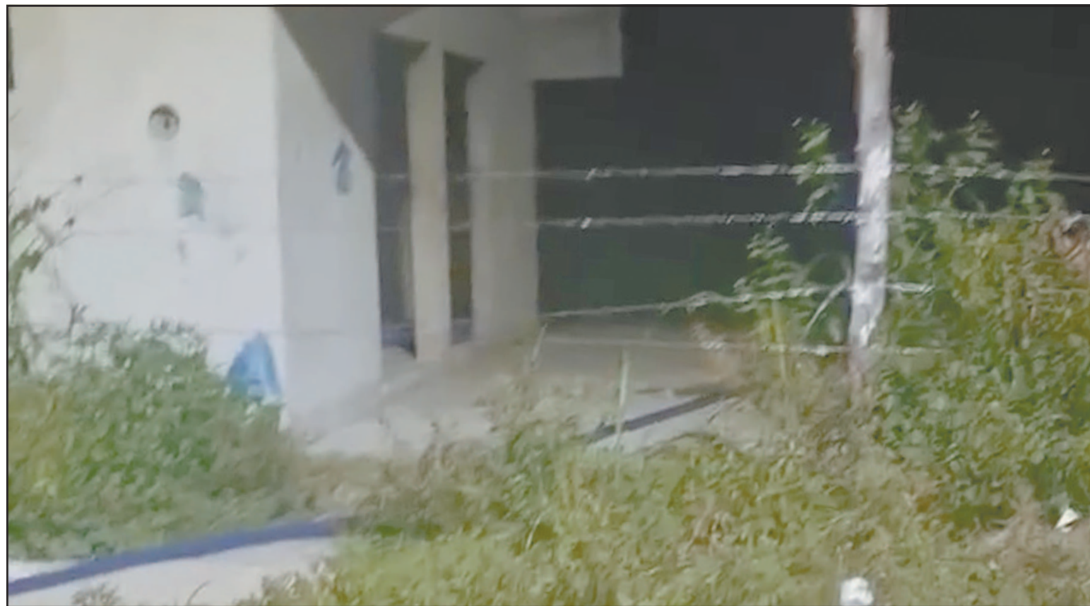
Una de las vecinas tomó fotos y las publicó en redes donde se muestra que una manguera descarga la fosa hacia el predio abandonado.
