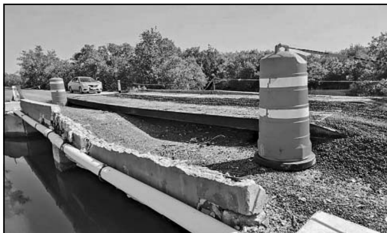
El tránsito constante de unidades pesadas deteriora esa vialidad.
