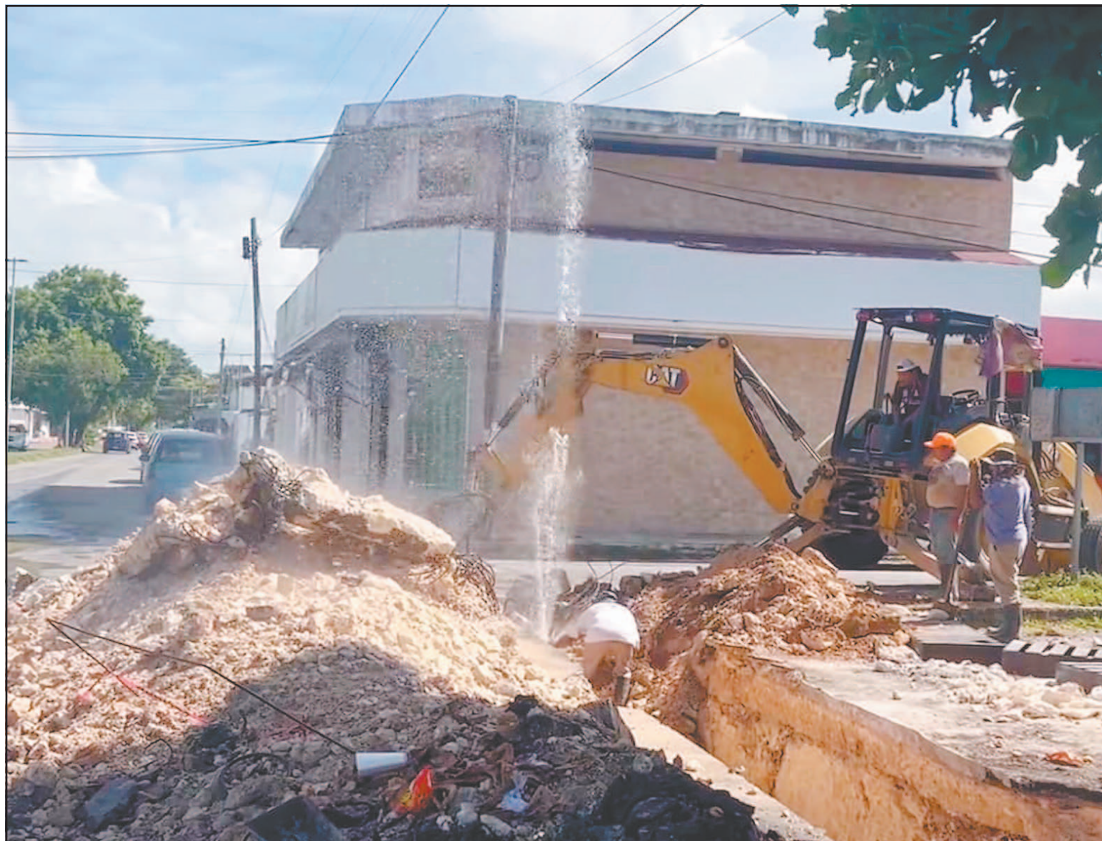
La fuerte filtración alcanzó los cinco metros de altura, lo que fue perceptible por vecinos que viven en los alrededores de la zona.
