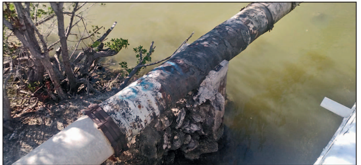
Pese al mantenimiento, los tubos ya cumplieron su ciclo de vida y ya urge reemplazarlos. (POR ESTO!)
