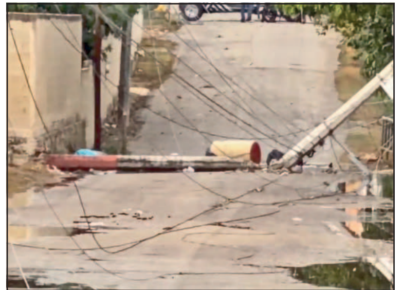
El desplome de las estructuras interrumpieron los servicios de luz.
