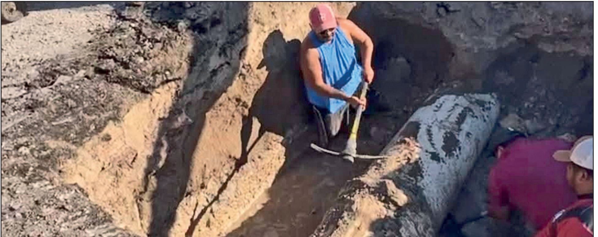
La tubería atraviesa por casi todo el municipio y beneficia a más de 190 mil habitantes de comunidades como Sabancuy e Isla Aguada, donde reportan fallas. (POR ESTO!)
