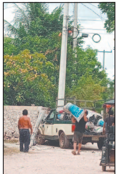
Un camión cargado con carbón derribó un poste y dañó cables.
