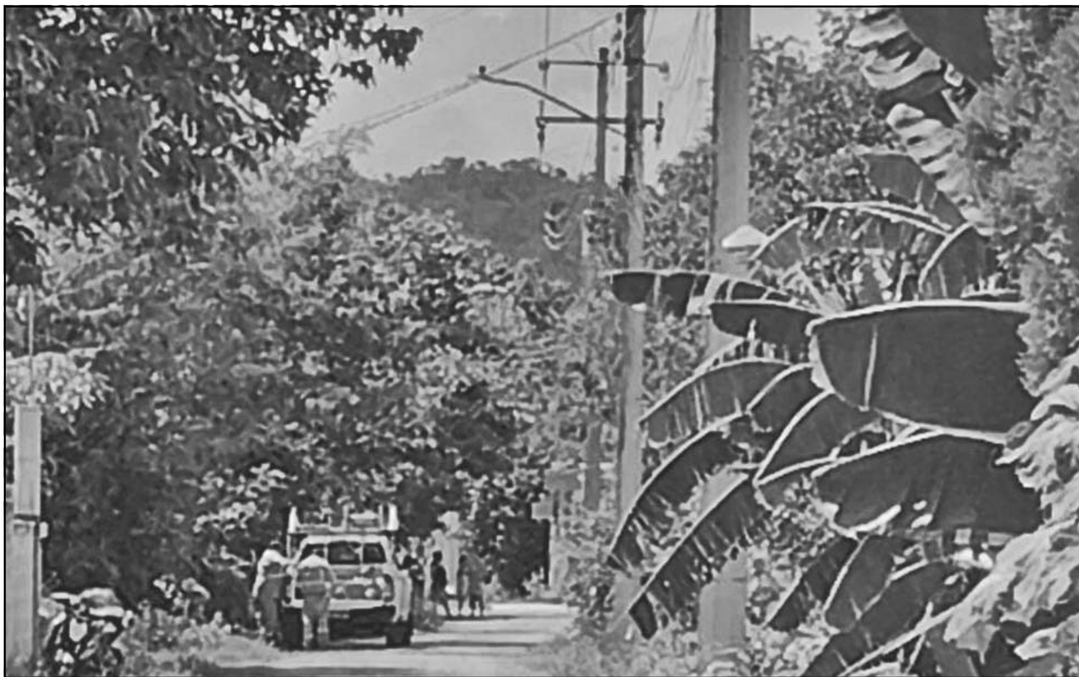
Varios cables chocan entre sí y dejan a todo el barrio sin electricidad, mientras los empleados dicen que no hay dinero para las reparaciones.
