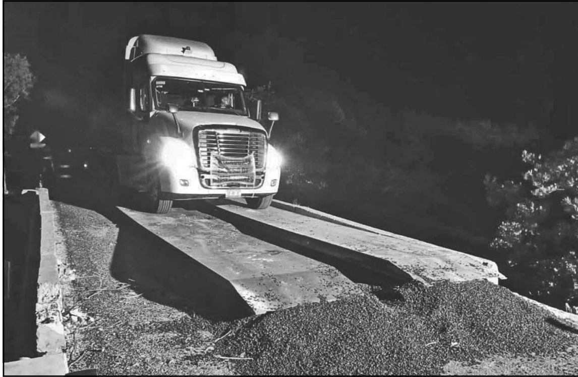
El pequeño puente estuvo expuesto mucho tiempo a la salinidad del ambiente y afectó sus materiales.
