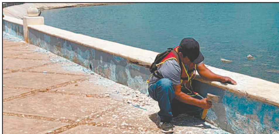
Se dará continuidad al programa de rehabilitación y evitar que el deterioro continúe.
