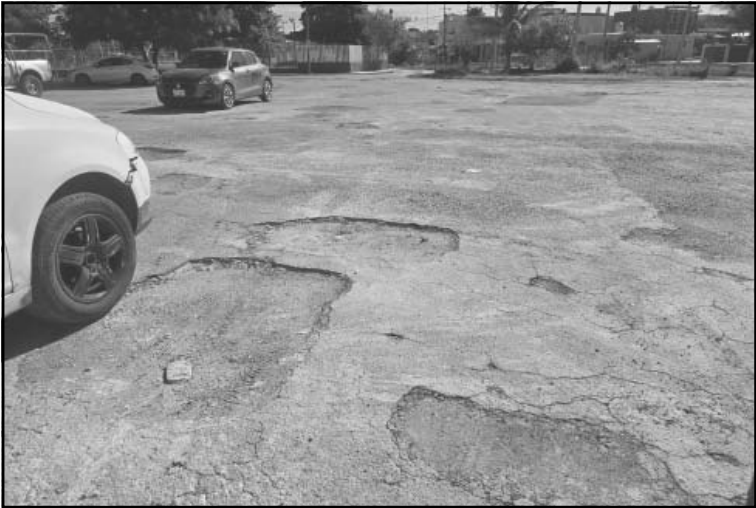
El espacio presenta numerosos baches que dificultan el acceso.
