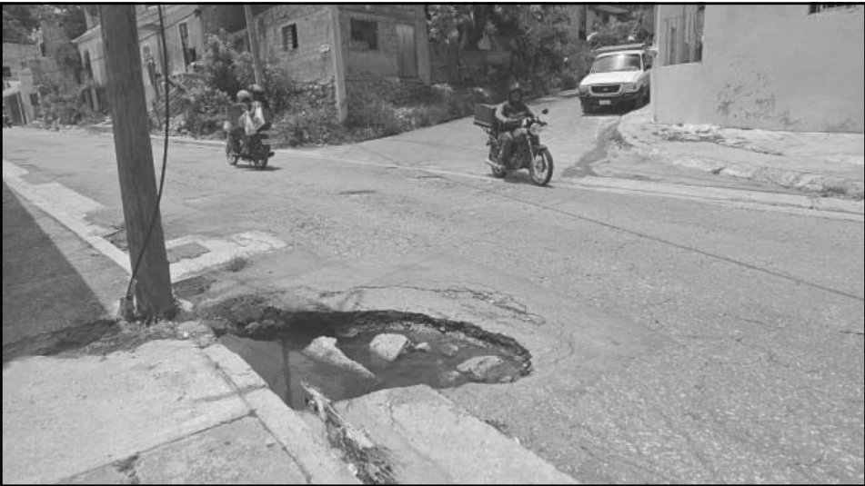
La Ecuador representa un riesgo por el constante flujo de agua proveniente de fugas.
