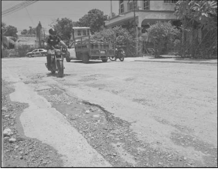
Residentes aseguraron que el bacheo ya no es suficiente. (A.Pech)
