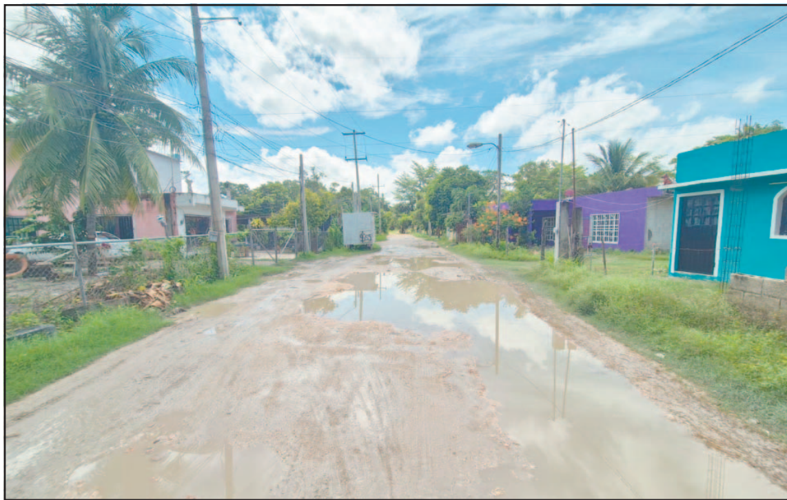
Más de 1.4 kilómetros permanecen sin infraestructura adecuada: las lluvias convierten la arteria en zona de riesgo.
