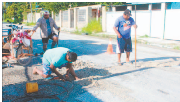
La excavación fue cubierta para evitar riesgos a peatones. (Especial)
