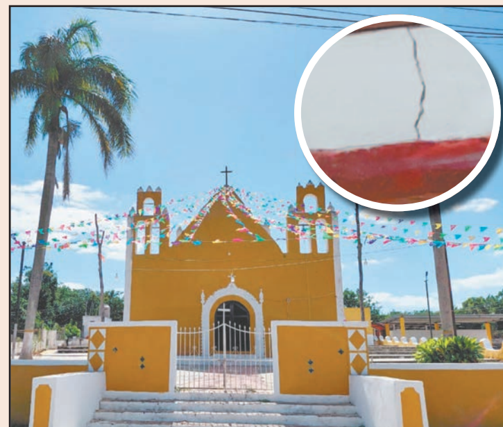
El desprendimiento del plafón pone en riesgo a los feligreses.
