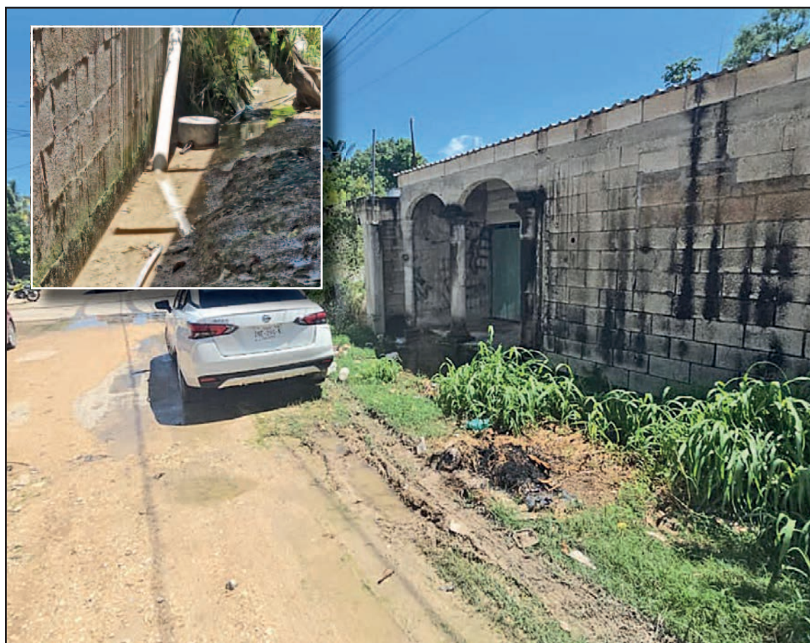
La humedad ha vuelto inhabitables algunas viviendas, obligando a sus propietarios a desocuparlas.
