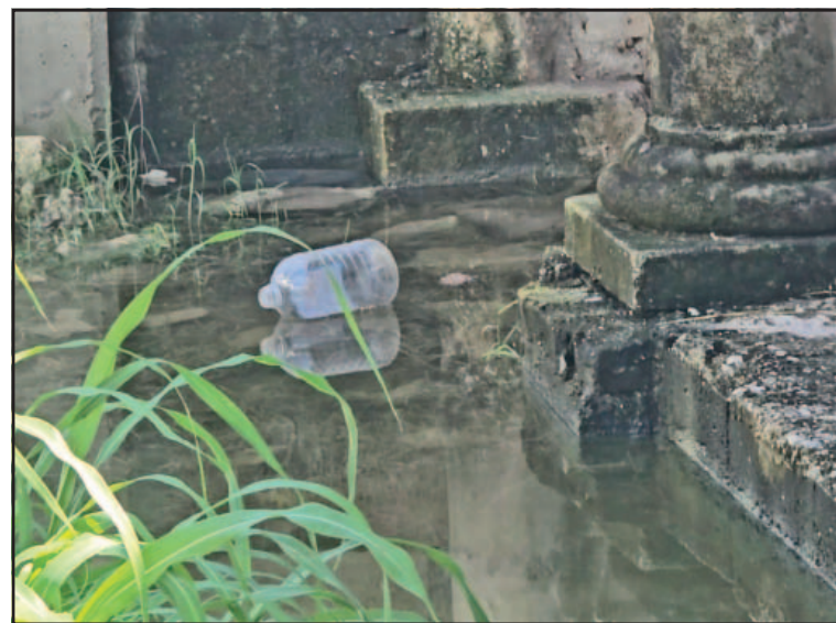
Toda la temporada de lluvias el patio se convierte en un estanque.
