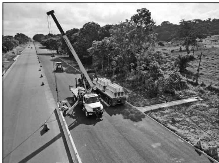
El tramo entre Tabasco y Escárcega se encontraba muy deplorable.
