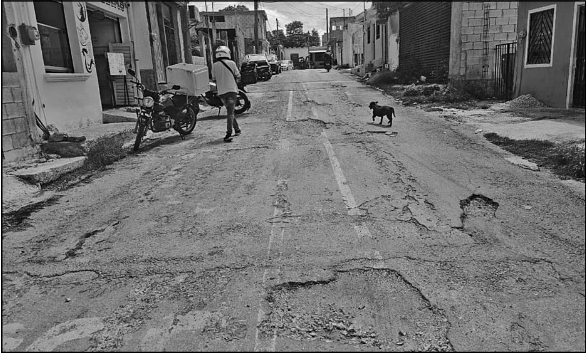
Cuando los baches son demasiados entre los mismos vecinos les echan material para poder transitar.
