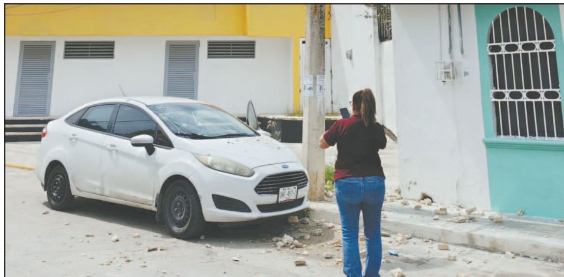
El derrumbe de la estructura provocó daños en el cofre y el techo de un auto estacionado en la colonia.
