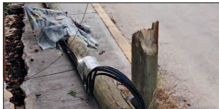
Vecinos señalan que la estructura ya estaba podrida. (Mauriel Koh)
