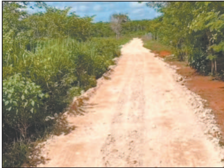
El acceso de Naranjal a Zafarrancho está dañado, pese a ser intervenido.
