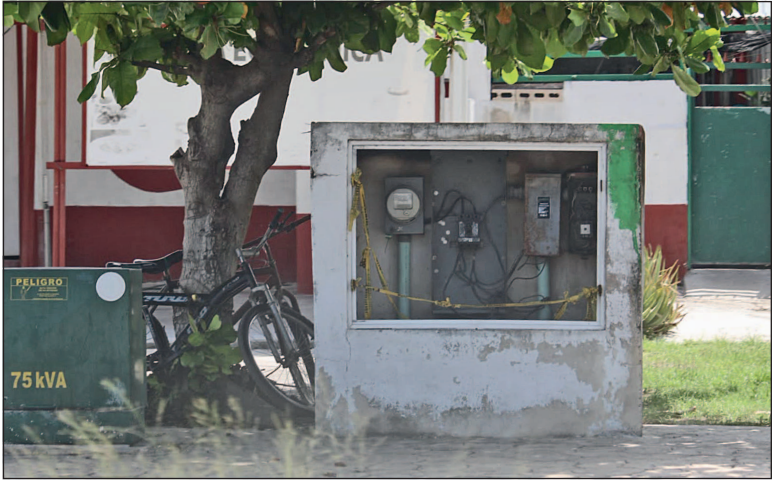
Los habitantes del lugar piden que la CFE o el ayuntamiento coloquen al menos cintas de prevención para evitar que alguien se acerque.
