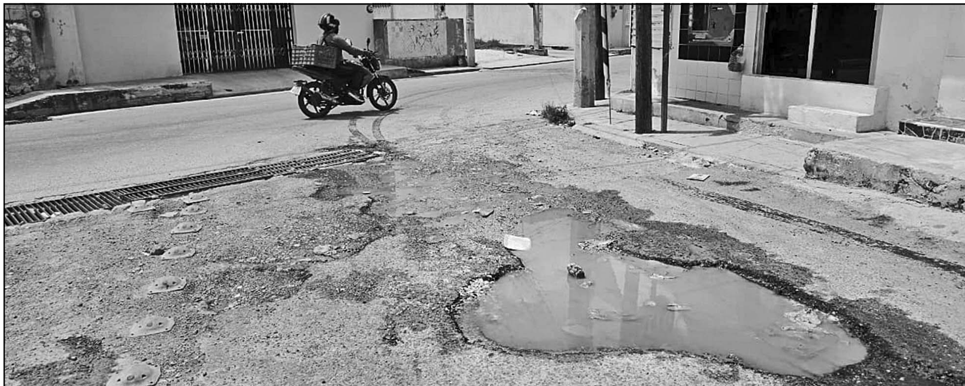
Un registro de drenaje pluvial permanece abierto en el cruce de las calles Ocho y 14 con avenida Álvaro Obregón, lo que representa un riesgo para peatones. (Alejandro Pech)
