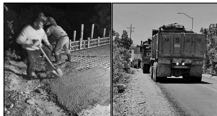
El puente se dañó por el paso de camiones cargados con material.
