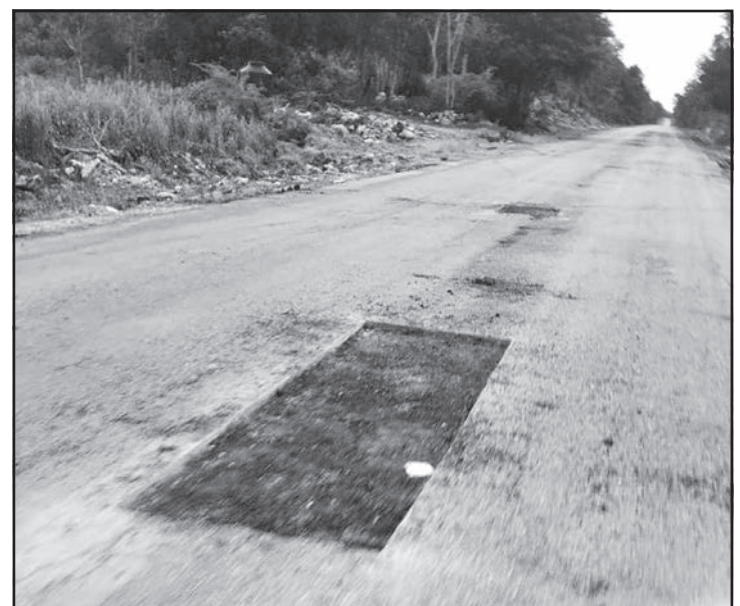
Son más de 12 kilómetros los que debe atender Obras Públicas. (J. Xiu)
