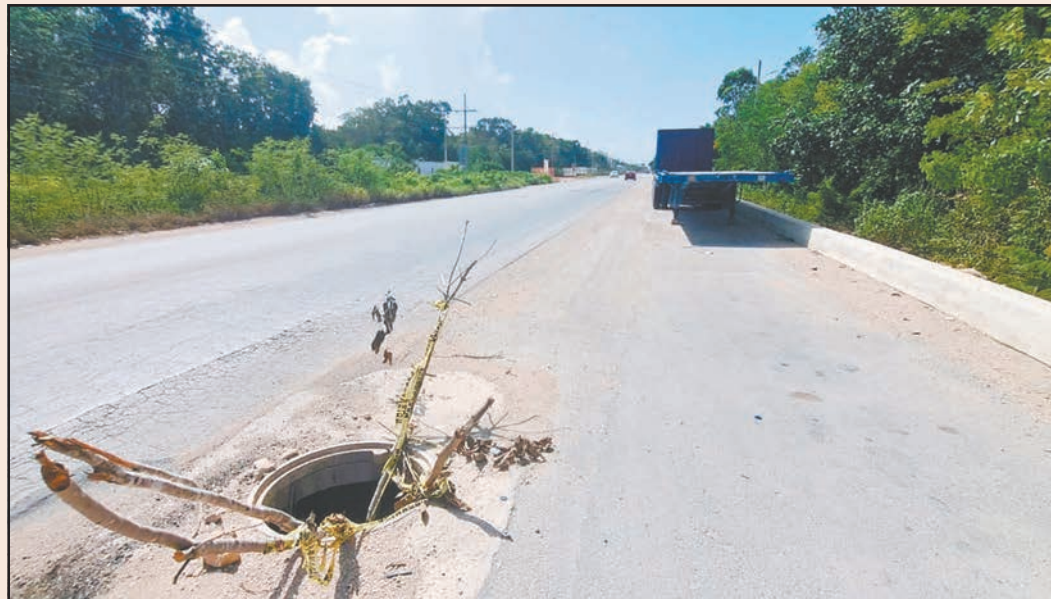
La proliferación de coladeras sin tapa es otro de los problemas en la carretera estatal. (E. Silva)
