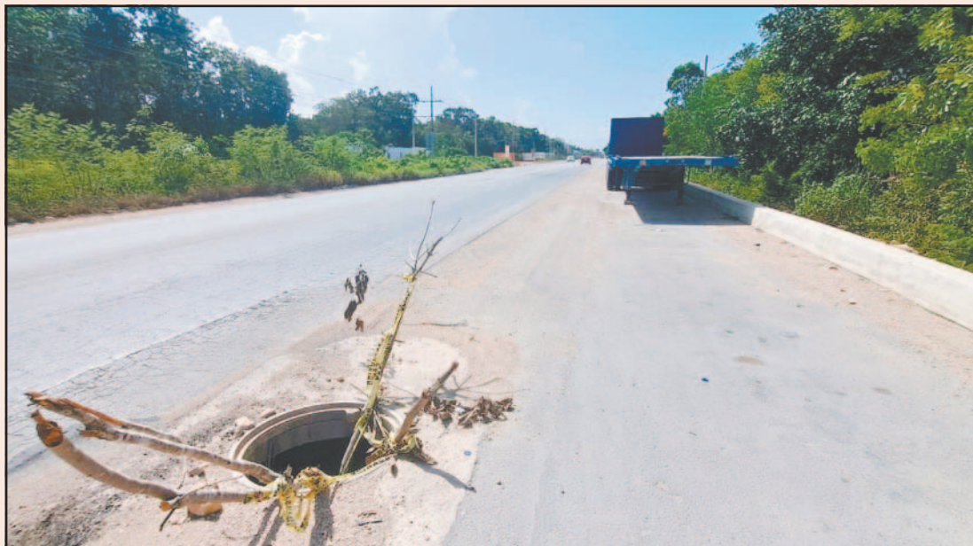
La proliferación de coladeras sin tapa es otro de los problemas en la carretera estatal. (E. Silva)
