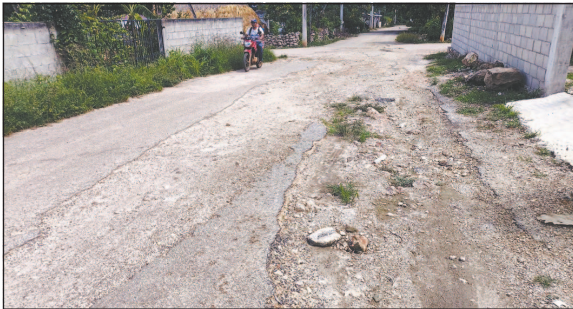
Las arterias requieren una rehabilitación integral debido al desgaste de la carpeta asfáltica. (Lusio Kauil)
