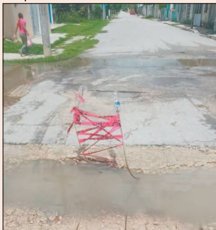
Se construyó para evitar encharcamientos, pero no funcionó.
